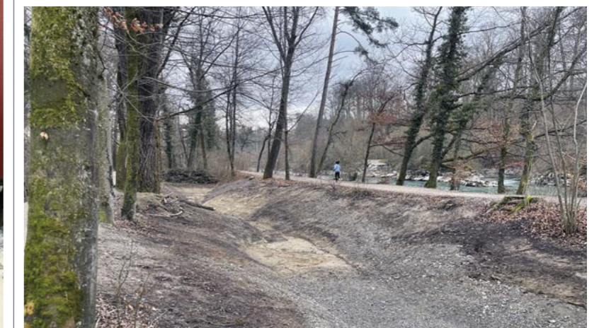
Aushub für die vergrösserten Teiche unterhalb der Fähribeiz. Diese sind Lebensraum für den Kammolch und weitere Lebewesen.
