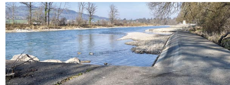
Muribad-Sporen: «Solange die oberste Betonbühne beim oberen Ausgang des Muribads Bestand hat, besteht keine Gefahr für das Muribad», sagt Geologe Hansruedi Keusen. Bilder: pp
